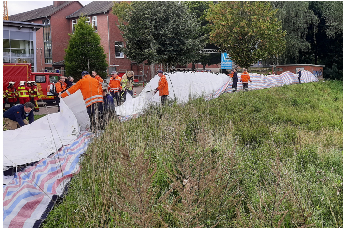
Die Feuerwehrkräfte stellen das Hochwasserschutzsystem auf. / Foto: Regionsfeuerwehr
